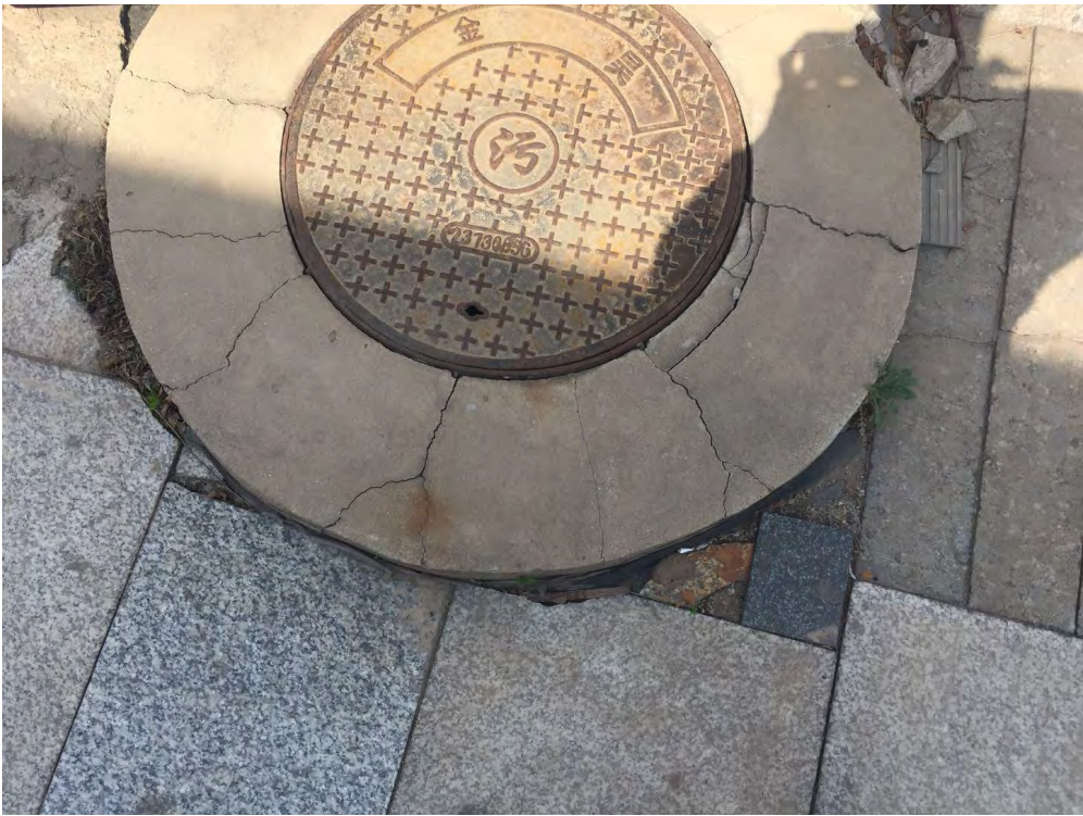
图 13 厂区总排放口
